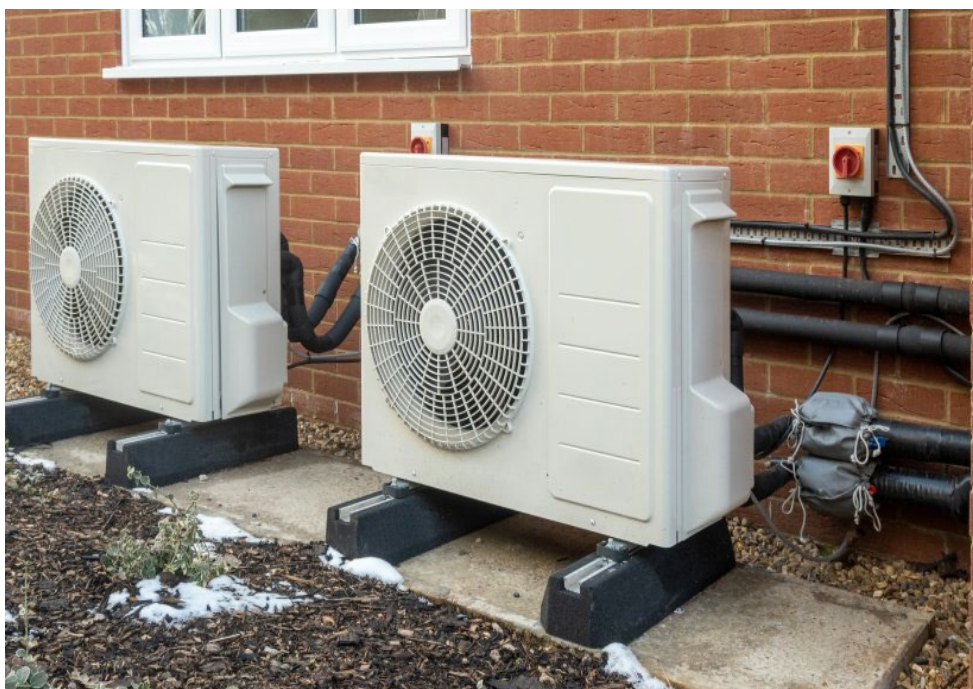
Sistemas HVAC con bombas de calor eléctricas
