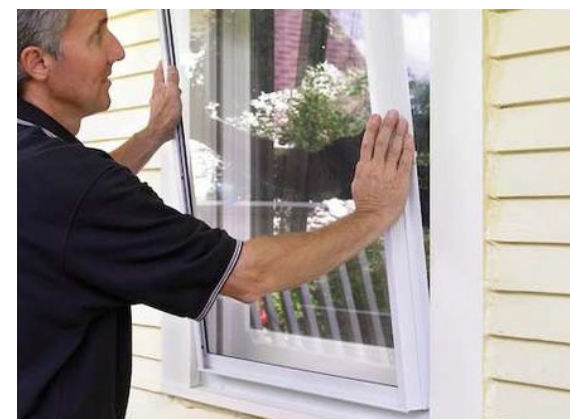
Reemplazo de ventanas/puertas con corrientes de aire
